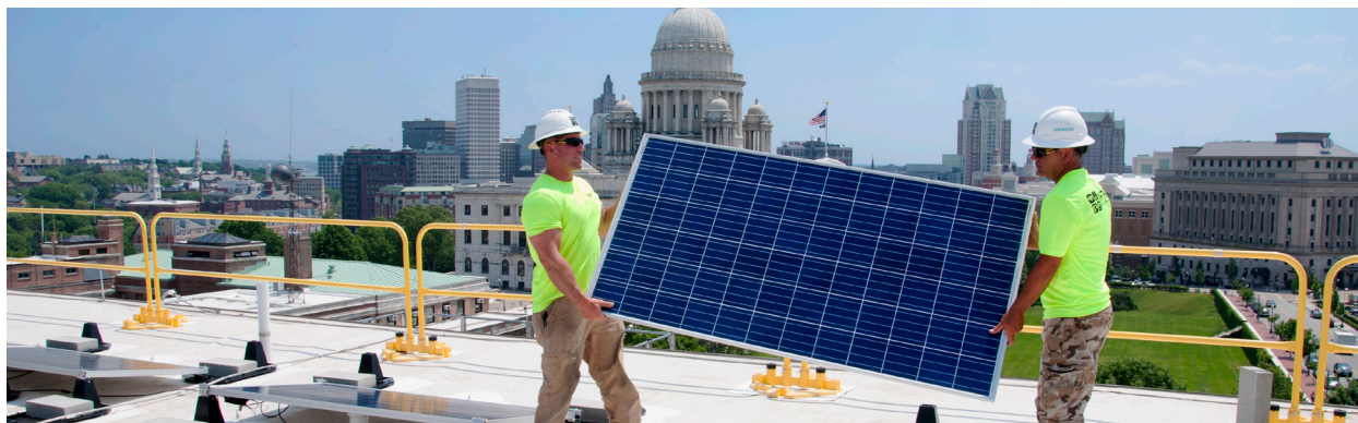
Sistema de paneles solares en la azotea del edificio del Departamento de Administración de Rhode Island.
